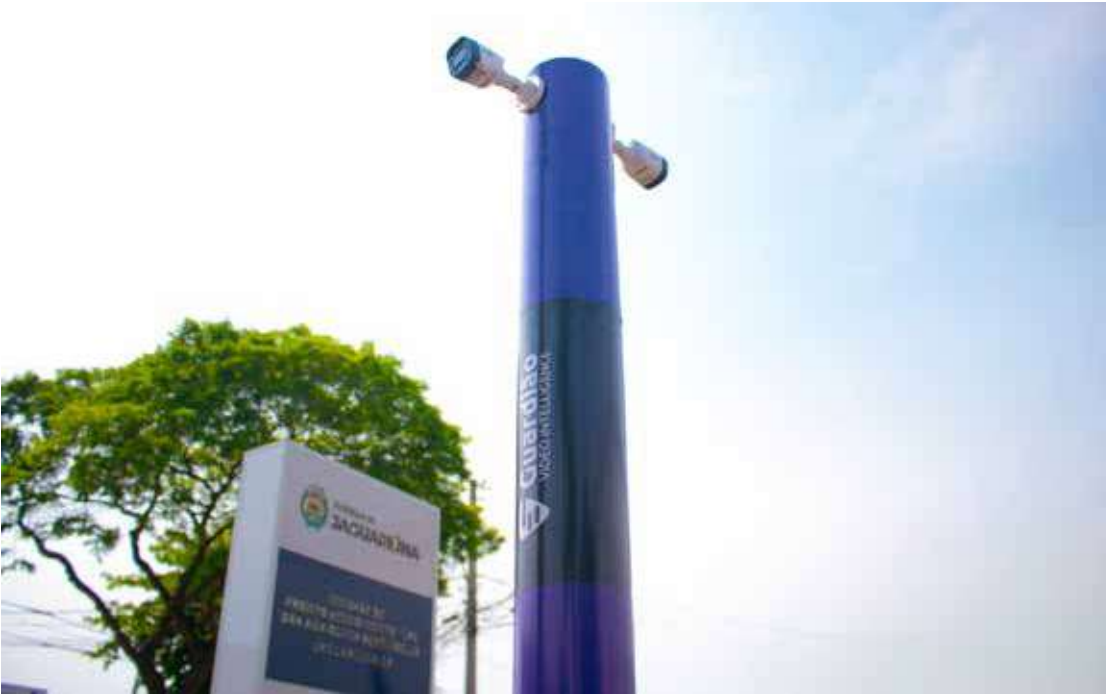
Com a instalação das novas câmeras, Jaguariúna amplia a cobertura de monitoramento em diferentes regiões da cidade
