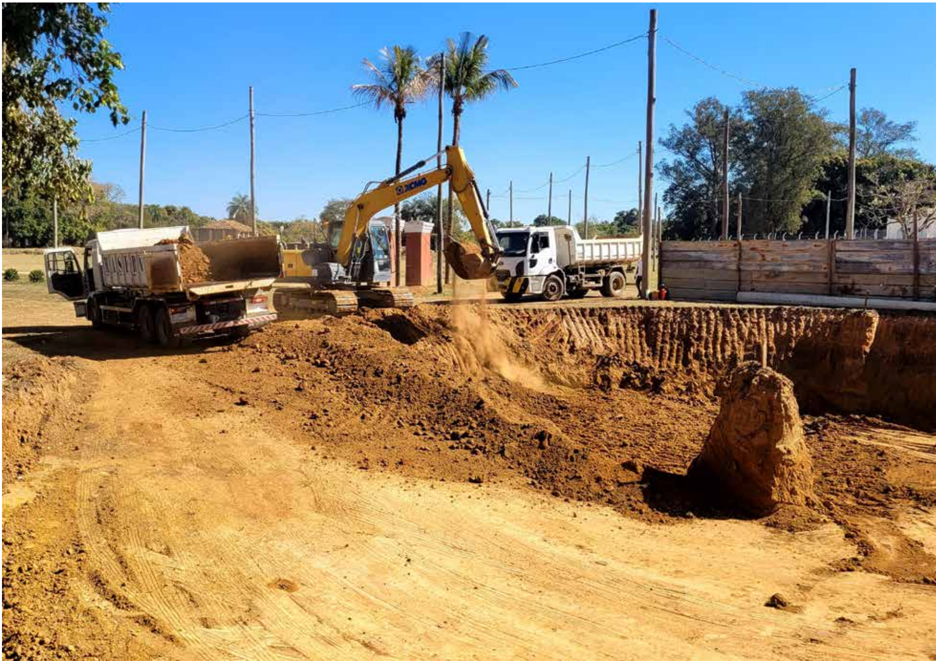
A ETA Camanducaia utilizará água captada do Rio Camanducaia – uma região nunca utilizada pelo município
