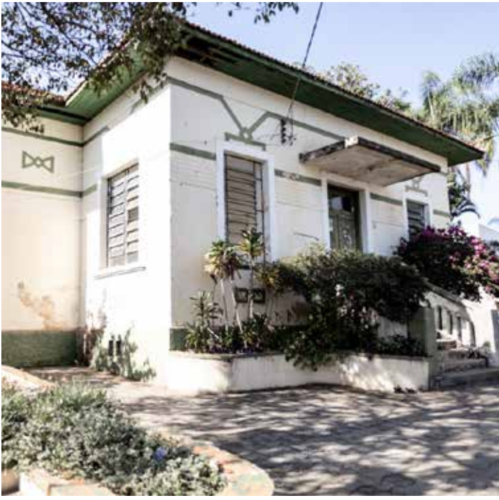
Local está desativado desde 2011, e o interior do imóvel sofre com infiltração e rachaduras
